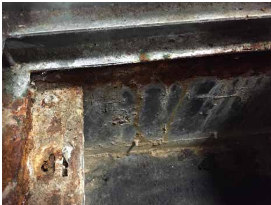
Infiltrazione dell'acqua nell'impianto di ventilazione.
